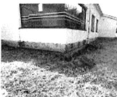
▲地盤沈下で建物が浮き上がる(石川県鳳凰寿荘)
